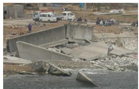
堤防が破壊された只越地区
