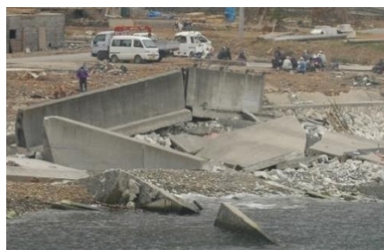
堤防が破壊された只越地区
